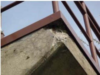
写真-1 付属物下のコンクリートの劣化
