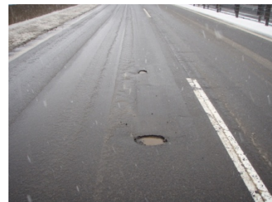
図-1 ポットホールの発生状況
