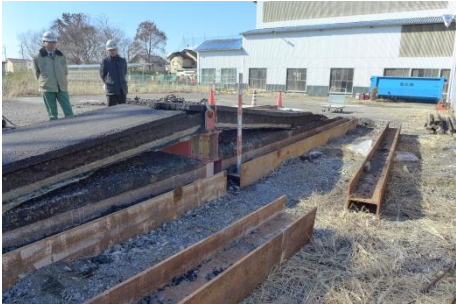
写真－１ 段差発生後の状況
