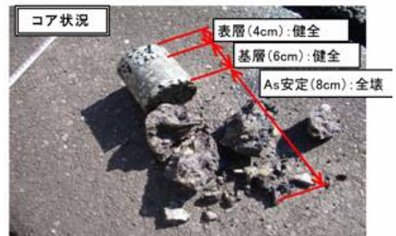
写真-1 高機能舗装における破損事例
