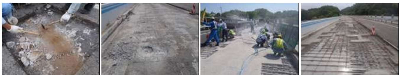
写真-1 損傷状況調査 写真-2 損傷状況（切削後） 写真-3 はつり 写真-4 はつり後
