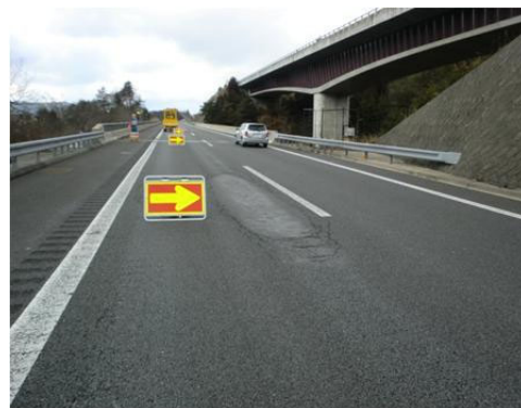
写真-1 損傷発生状況
