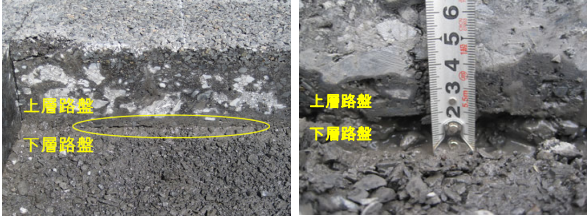
写真-4 上・下層路盤間の隙間
