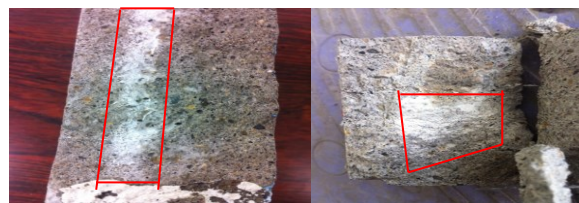
図-2 ひび割れにおける \text{CaCO}_3 の析出状況
