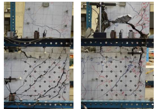
(a) N 試験体 (b) P 試験体 図-5 +7\delta_y 時のひび割れ状況
