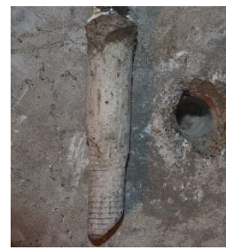
(a)破壊面移行の例
