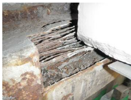
写真-4 桁干渉部のケーブルカバー切欠き部のケーブル鋼より線の破断
