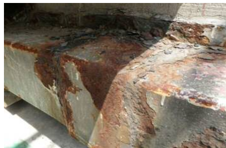
写真-2 ケーブルカバーの腐食
