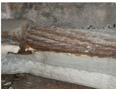
写真-3 グラウト未充填箇所のケーブル 鋼より線の発錆
