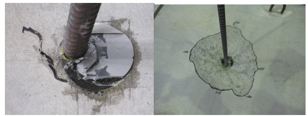
(a) 樹脂の部分剥離 (b) コーン状剥離 写真－2 定着部の破壊状況の一例
