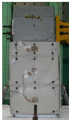
写真2 損傷状況 (No.1)
