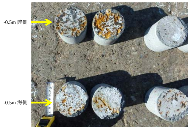
写真-3 採取したコアの鋼材表面側の状況
