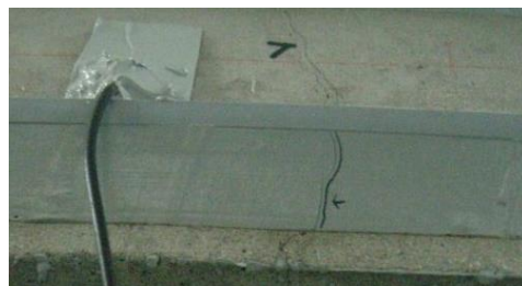
写真-2 ひび割れ発生状況
