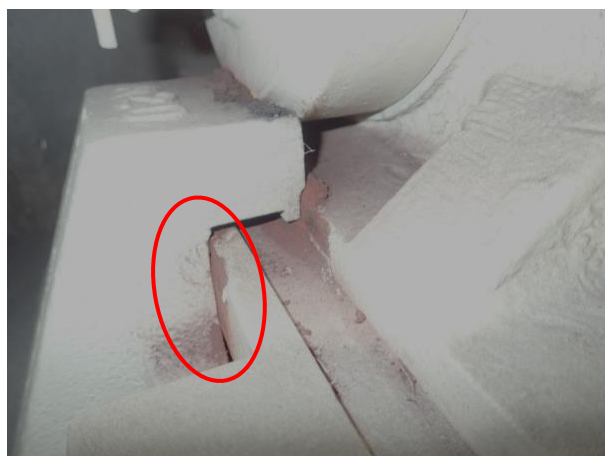
写真-2 サイドブロックと下支承の接触部
