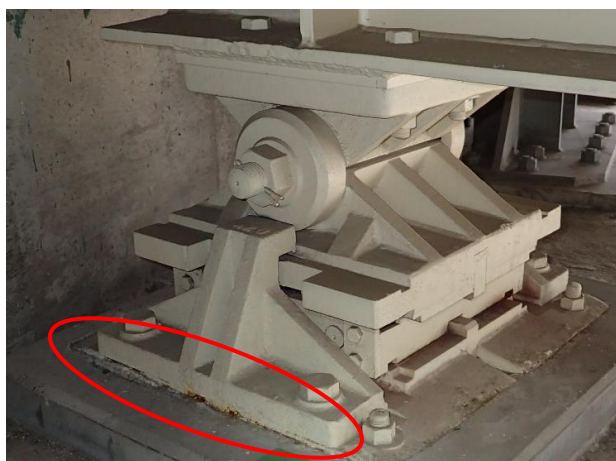
写真-3 コンクリートとの境界部の発錆
