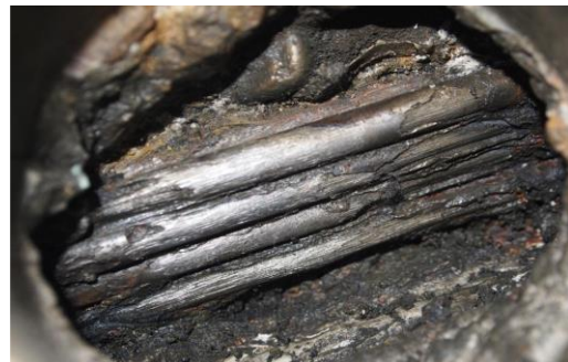
写真-1 既設 PC 道路橋の鋼線の腐食状況
