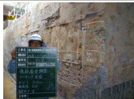
写真-3 鉄筋露出箇所
