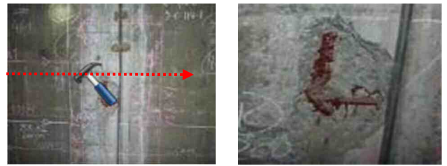
図-4 打音調査箇所（鉄筋露出・剥離周辺）
