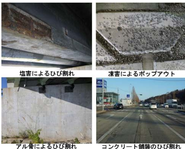
図-4 各種コンクリートひび割れ損傷写真
