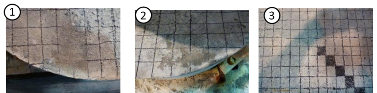
図-9 ひび割れ面における損傷箇所(左,中央)と中心部分(右)
