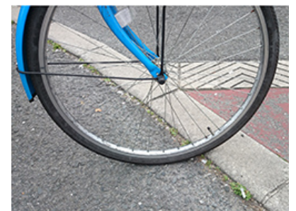
図-5 自転車道における段差
