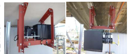
a) カメラ b) マーカー 図 4-3 取付位置状況写真
