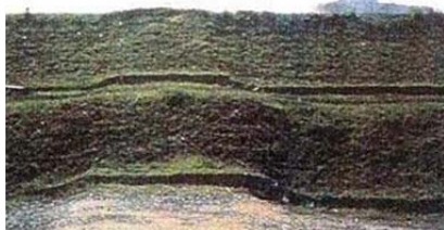
図1 構造物周辺堤防における拔け上がり現象の例
