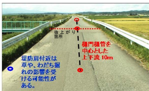
図3 拔上がりのある試験地の天端状況
