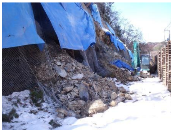
写真-1 崩壊直後の様子
