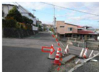
写真-1 a点における1.0m以上の水平変位(A地区)
