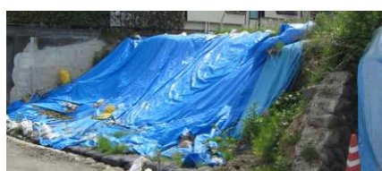
写真－1 ひな壇部分の変形・崩壊被害
