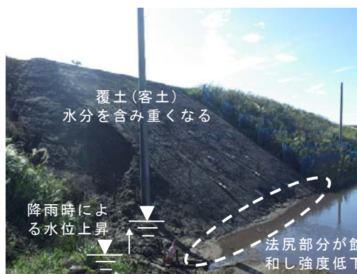
Photo.2 覆土の斜面崩壊の原因
