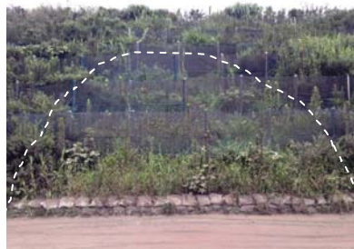
Photo.1 斜面崩壊の痕跡（白線部）
