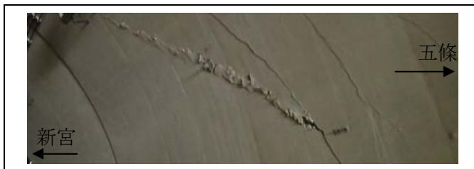
写真-1 覆工亀裂（山側壁面）
