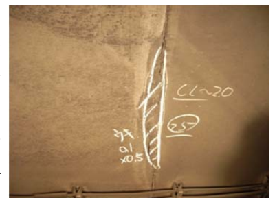
写真-1 目地周辺のうき
