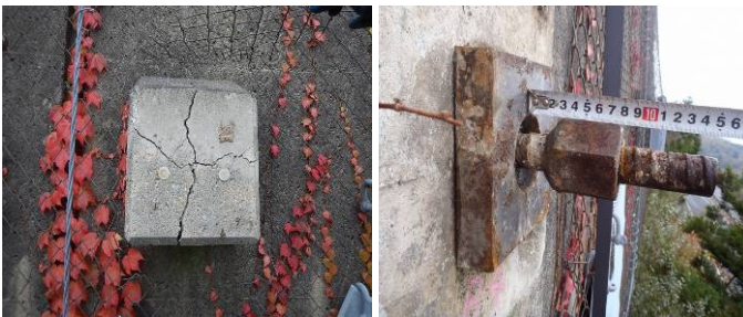
写真-3 コンクリートキャップの亀裂および浮きの状況
