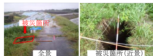
写真1 樋門周辺地盤に発生した空洞 1)
