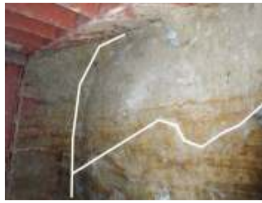
図-5 切羽割裂状況
