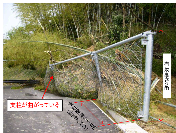
写真1 土石流捕捉状況
