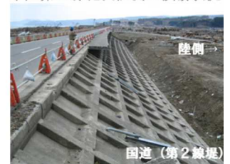
(e) 第2線堤裏法面の損傷状況
