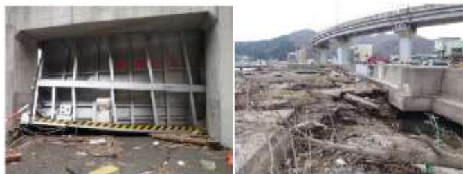
写真-1 東北地方太平洋沖地震津波による陸閘の被災 左：陸閘が陸側に破損した事例（宮古港海岸） 右：海側が洗掘され扉体が流出した事例（釜石港海岸）
