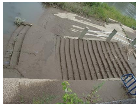
図-1 堆積した土砂の様子
