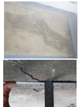
写-1 RC 床版のひび割れ
