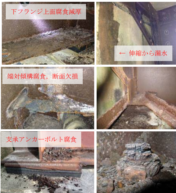
写真 2 桁端部の腐食劣化状況
