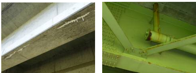
写真-2 B橋遊離石灰(左), C橋排水管腐食(右)
