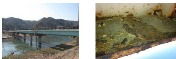
写真-1 A橋全体(左)、腐食した主桁(右)
