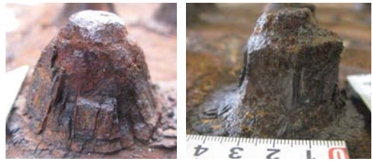
写真 1 摩擦接合継手の高力ボルトの腐食減肉例
