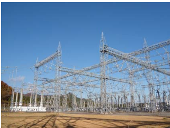
図-2 母線鉄構の外観
