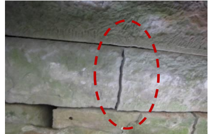
写真1 曲げによる石材の割れ
