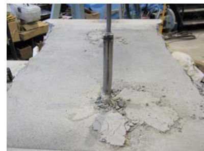
図5 打継ぎ目の損傷状況 (No.1)
