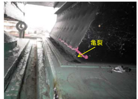
写真-1 損傷状況
