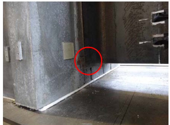
写真-1 間詰部のひび割れ
