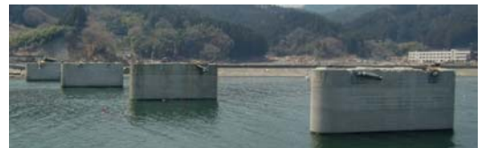
(b) 被災後 写真-1 気仙大橋
