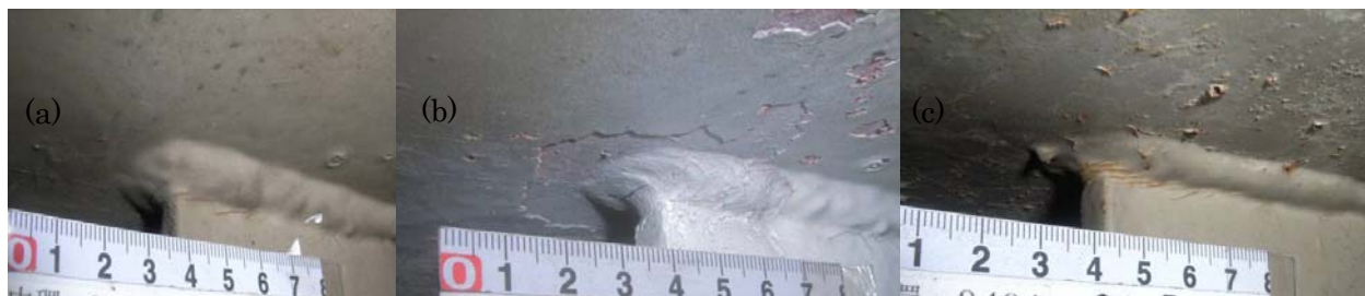
写真-2 塗膜割れからのき裂検出
