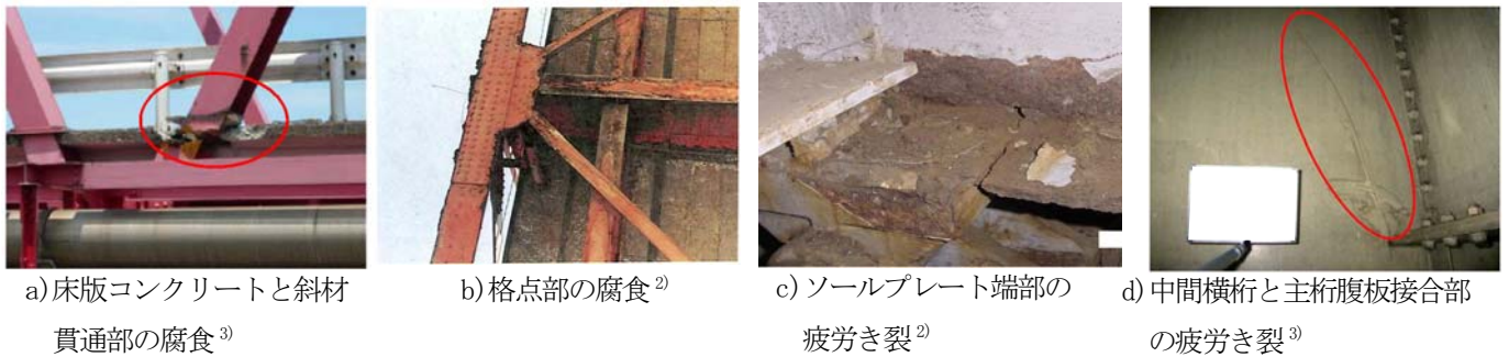
写真-1 鋼道路橋の損傷事例
