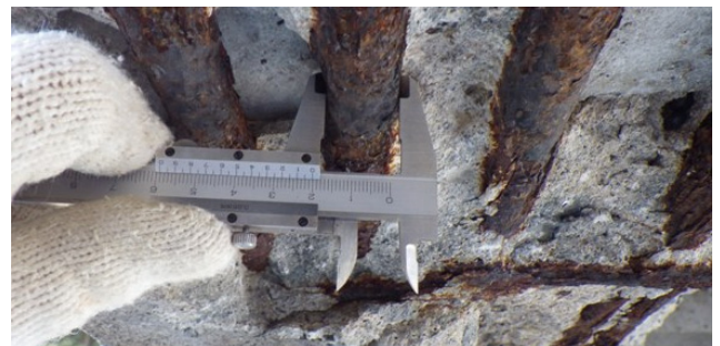
図-6 主鉄筋の錆びによる断面欠損
