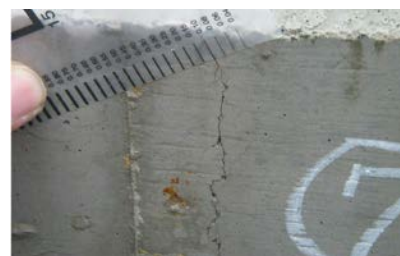
図-1. 防油堤ひび割れ状況
